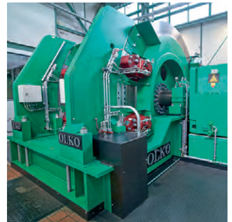
Fördermaschine im Salzabbau mit OLKO-Sicherheitsbremsanlage.
